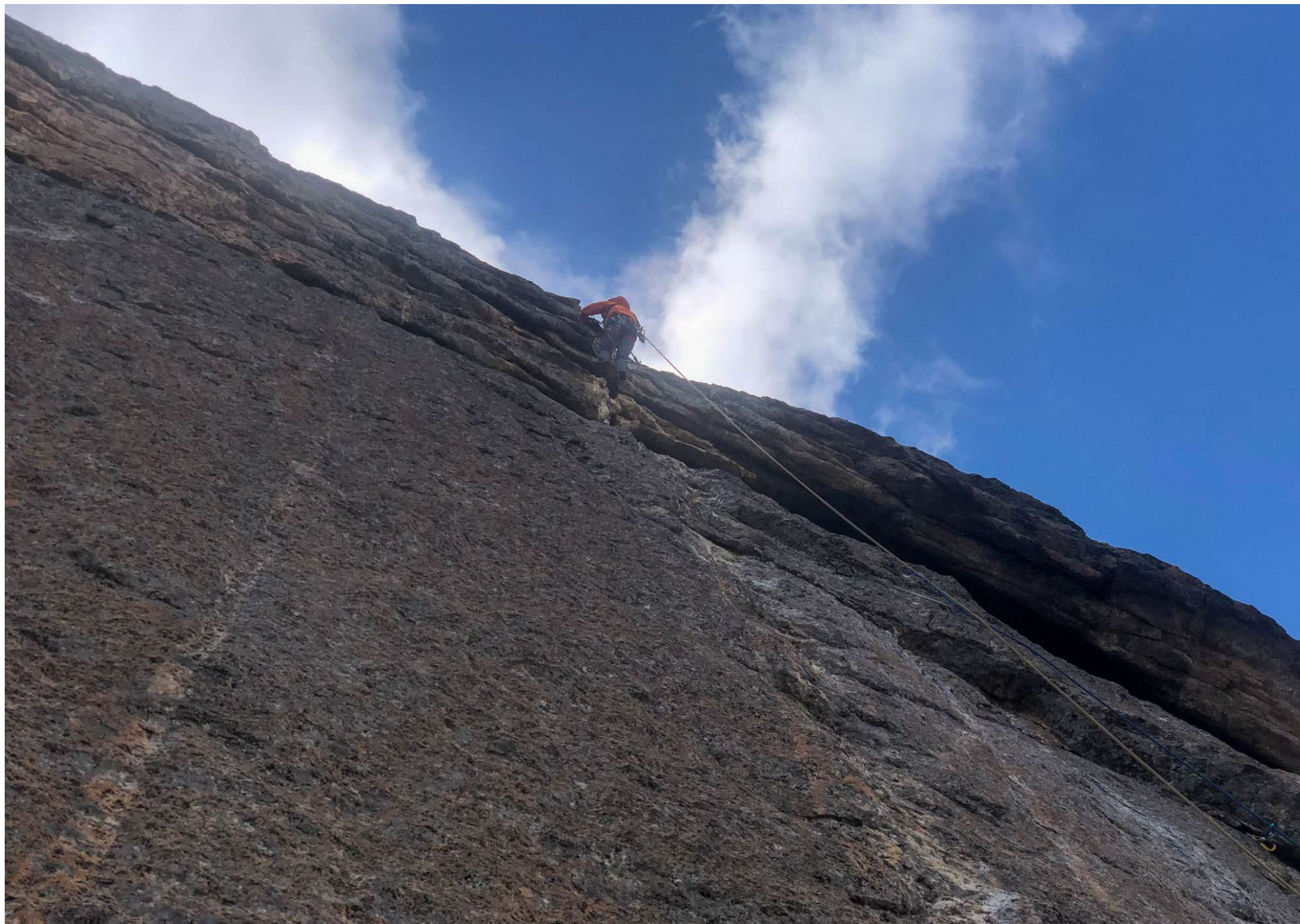
Фото 10. Карниз на участке R 17 – R 18
