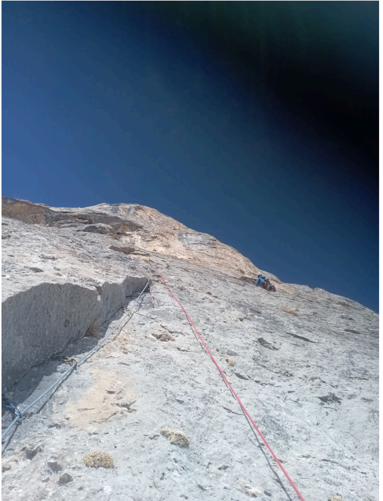
Рисунок 12 Фото – работа 16.02.2024 на участке R8– R9 (один из ключевых участков протяженностью более 100м)
